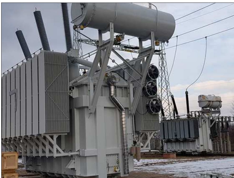
W przyszłym tygodniu nowy transformator sieciowy (na pierwszym planie) zastąpi dotychczasowy (w tle).
